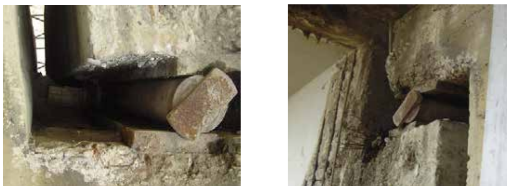
Figura 2. Situația podului de pe râul Trotuș, localitatea Gura Văii, județul Bacău a) degradări ale aparatelor de reazem (detaliu); b) degradări ale betonului la reazeme și ale pilonilor de susținere.
